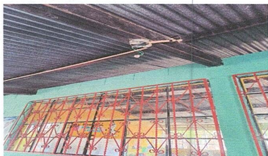
Foto 5: sustitución de lámparas tipo LED
