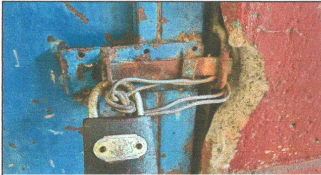
Foto 3: Puertas de las aulas
