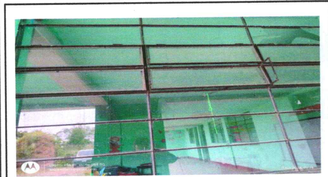
Foto 3: Estructura de metal de ventanas en mal estado
