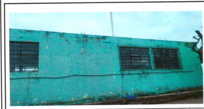
Foto 5: Bajada de agua pluvial en mal estado
