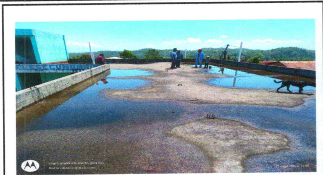
Foto 1: Losa de terraza en mal estado
