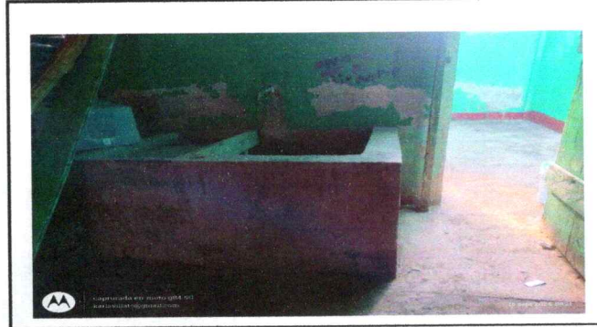
Foto 4: Piso de concreto en mal estado
