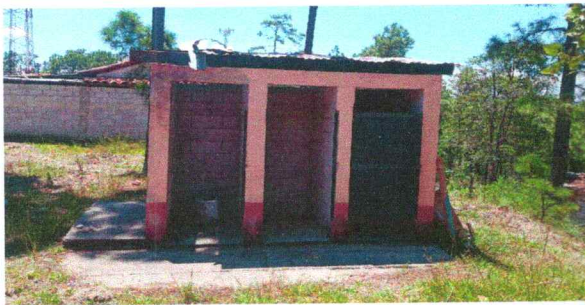
Foto 3: Puertas de sanitarios deteoreadas
