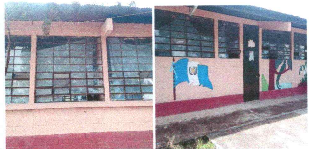
Foto 4: Ventanales y vidrios en mal estado
