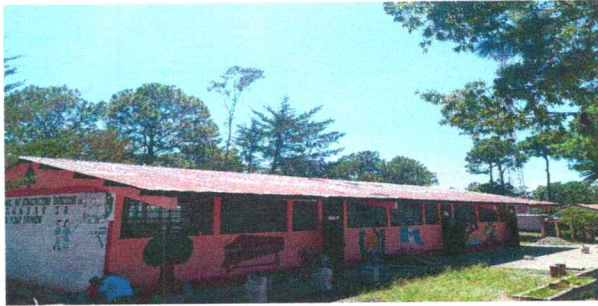
Foto 1: Cubierta de lámina deteoreada
