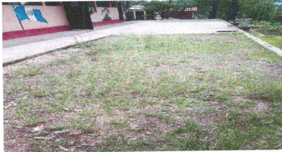
Foto 1: Losa de patio detereorada
