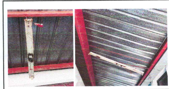
Foto 6: Lámparas y sistema eléctrico en mal estado
