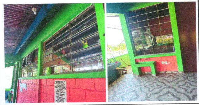
Foto 2: Ventanales tipo balcón deteriorados no se abren las partes móviles para la ventilación, occidadas y vidrios quebrados
