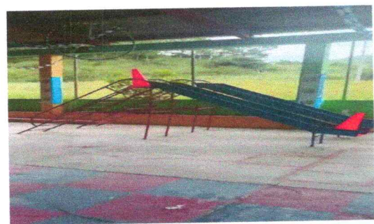
Foto 3: Pintura del centro educativo en mal estado
