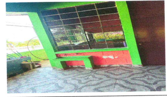
Foto 4: Pintura deteriorada en todo el centro educativo
