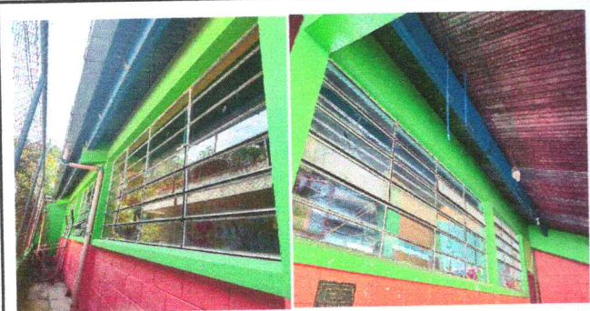
Foto 1: Ventanales tipo balcón deteriorados no se abren las partes móviles para la ventilación, occidadas y vidrios quebrados
