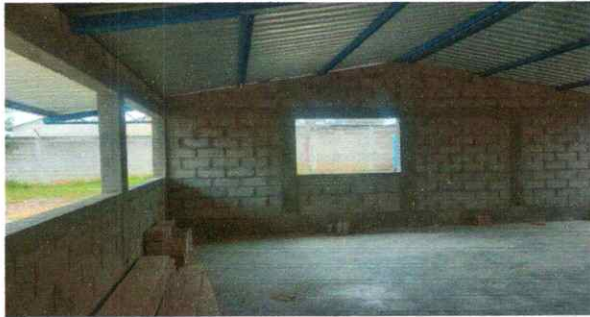
Foto1: Falta de piso en aula
