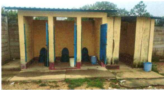
Foto 3: Sanitarios detereorados y paredes dañadas necesitan protección
