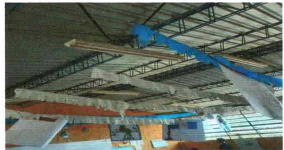
Foto 4: Sistema eléctrico de todo el centro educativo detereorado, lámparas no funcionan
