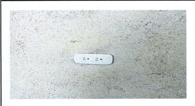
Foto 4: Sistema eléctrico nuevo e instalado
