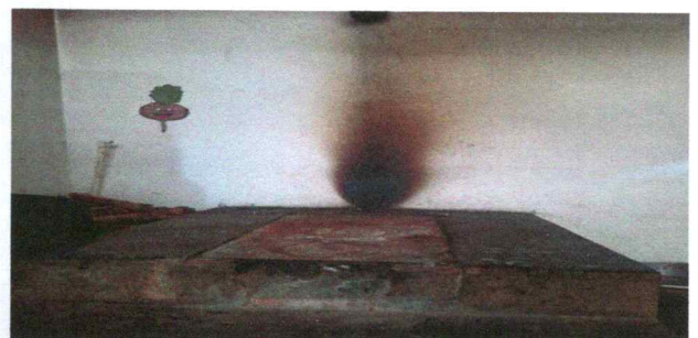
Foto 6: Chimenea de metal quebrada
