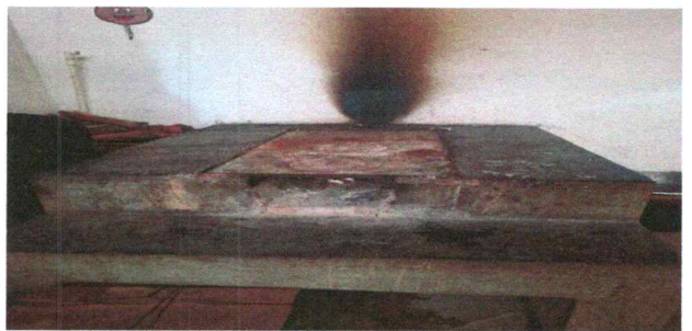
Foto 5: Plancha de estufa rural en mal estado
