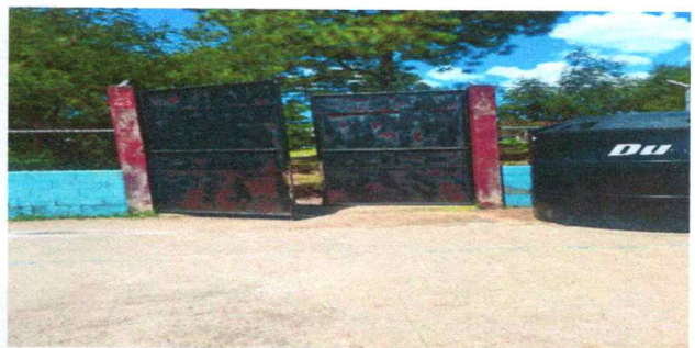
Foto 4: Portones en mal estado
