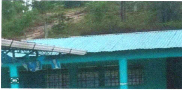
Foto 1: Cubierta de lámina en mal estado
