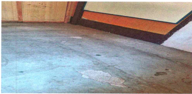
Foto 3: Piso de cocina quebrado y rajado
