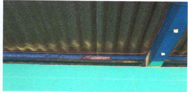
Foto 2: Estructura de soporte de madera en mal estado
