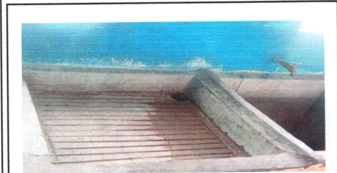
Foto 5: Pila en mal estado
