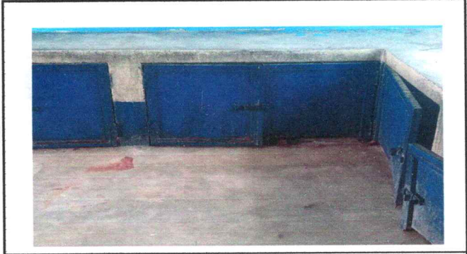
Foto 2: Puertas de mueble de concreto en mal estado
