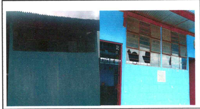
Foto 4: Vidrios en mal estado quebrados a falta de balcón
