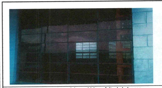
Foto 5: Ventanas expuestas quiebran vidrios a falta de balcones
