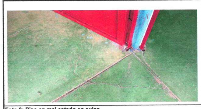
Foto 6: Piso en mal estado en aulas
