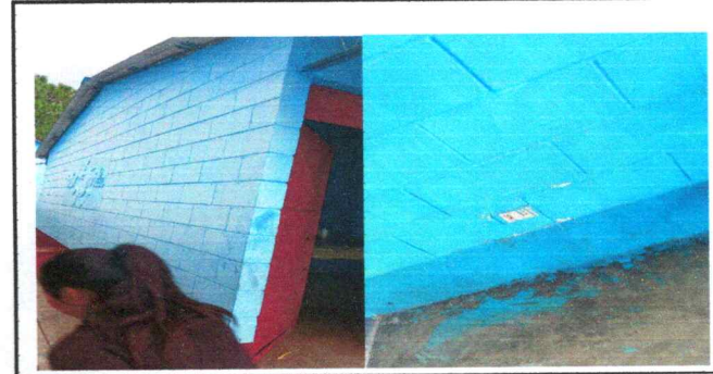
Foto 6: Pintura en malas condiciones
