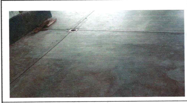
Foto 2: Piso en malas condiciones en cocina
