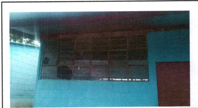
Foto 3: Ventanas expuestas quiebran vidrios a falta de balcones
