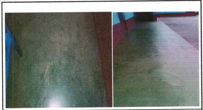
Foto 1: Piso en malas condiciones en aulas y corredor
