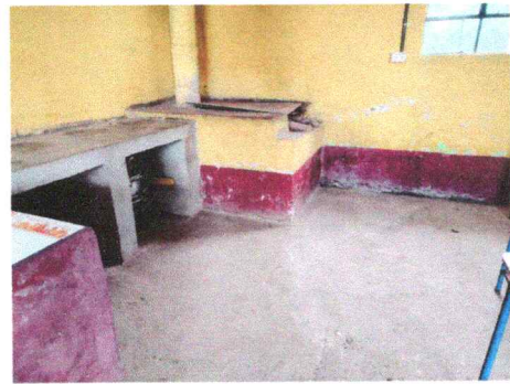
Foto 4: Cocina con piso de concreto en mal estado
