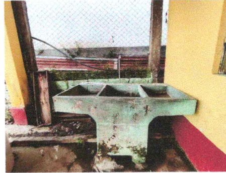
Foto 2: Pila en malas condiciones
