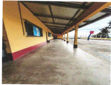
Foto 10: Patio con piso de concreto en malas condiciones
