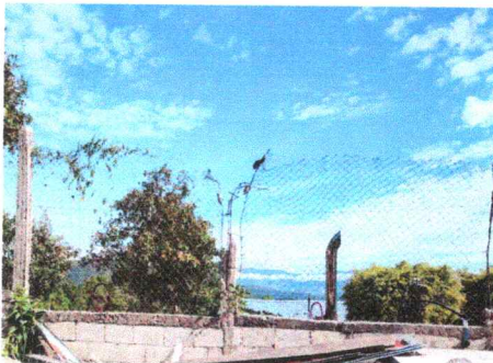
Foto 11: Muro perimetral arruinado
