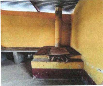
Foto 1: Plancha en mal estado
