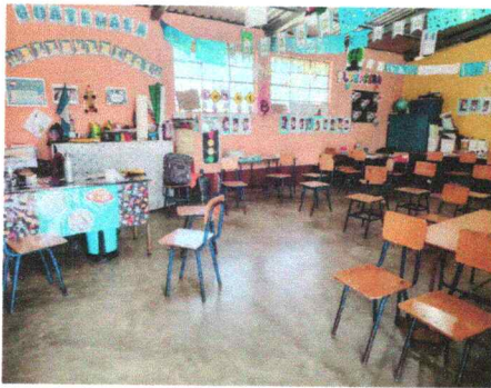
Foto 9: Aulas con piso de concreto deteriorado
