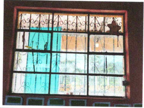
Foto 8: Vidrios deteriorados e incompletos
