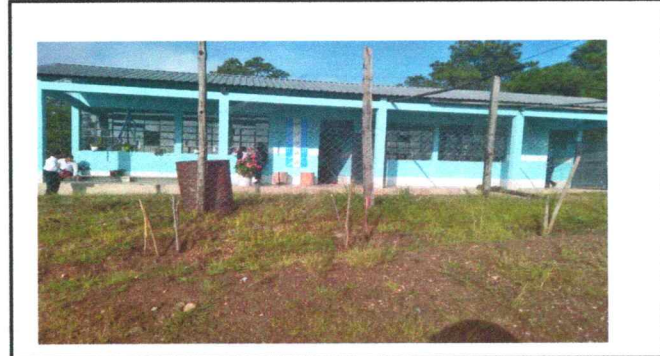
Foto 4: Muro perimetral deteriorado existe inseguridad para alumnos ya que a la par del centro educativo existe carretera pública transitada
