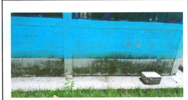
Foto 2: Pintura deteriorada en todo el centro educativo
