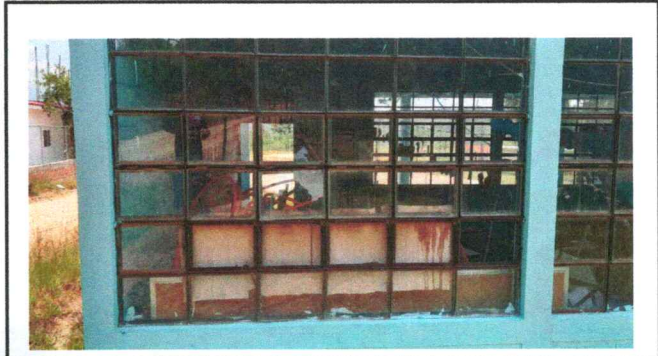
Foto 4: Estructura de ventanas de metal en mal estado y vidrios quebrados
