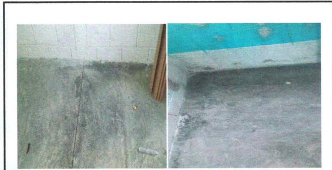
Foto 6: Piso de cemento líquido en mal estado
