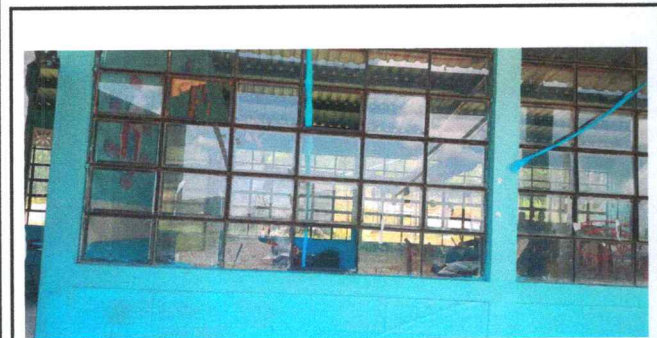
Foto 5: Ventanas expuestas falta de seguridad sin balcón
