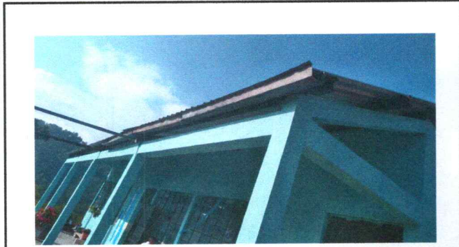
Foto 1: Canales de metal deteriorados
