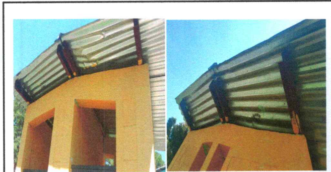
Foto1: Cubierta de lámina y estructura de soporte detereorada en baños
