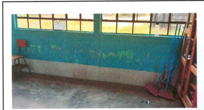
Foto 3: Pintura deteriorada en todo el centro educativo
