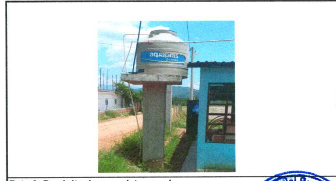
Foto 6: Depósito de agua deteriorado
