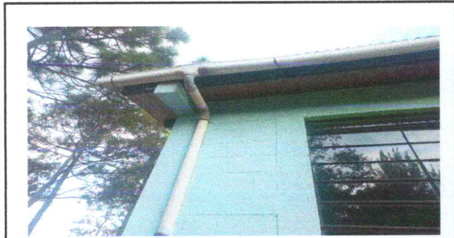
Foto 3: Canales de PVC en mal estado
