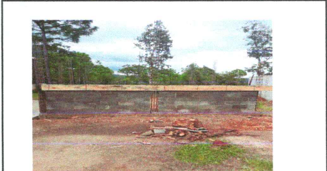
Foto 2: Mejoramiento a cocina en cubieta de lámina, estructura de soporte, puertas, ventanas, piso, sistema eléctrico, estufa rural, mueble de concreto y lavatrastes
