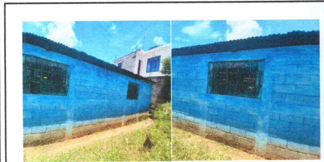
Foto 5: Ventanas deteterioradas y vidrios quebrados
