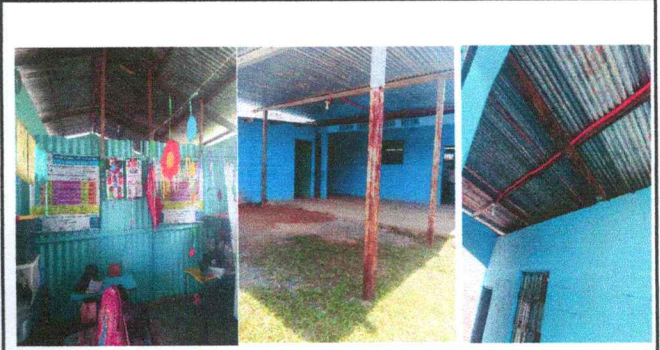
Foto 2: Estructura de techo en mal estado
