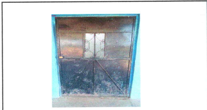
Foto 3: Puerta de aulas y cocina en mal estado
