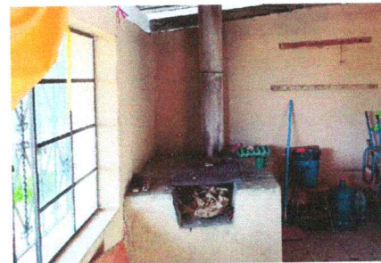
Foto 6: Estufa rural en mal estado
