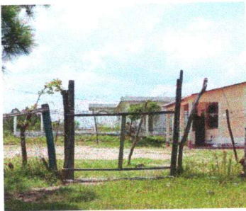
Foto 5: El portón se encuentra en mal estado
