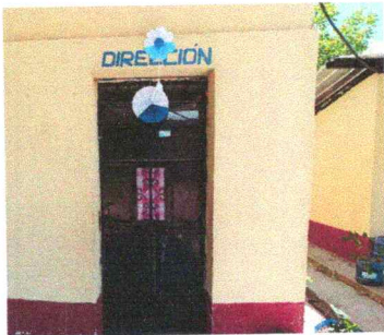
Foto 3: La chapa esta dañada
