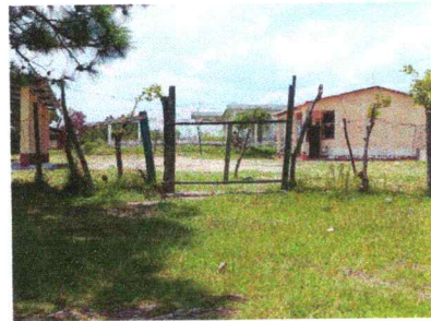
Foto 4: Muro perimetral deteriorado
