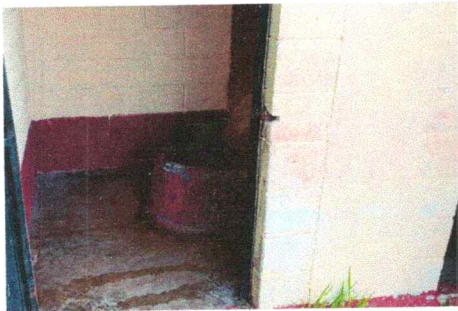
Foto 3: Los sanitarios en mal estado
