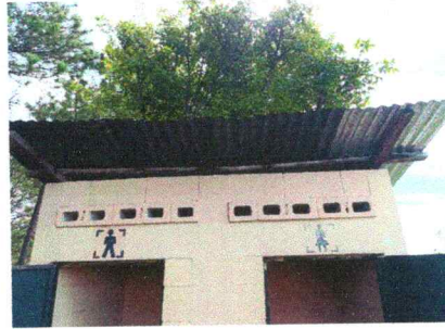
Foto 2: La estructura de techo esta dañada
