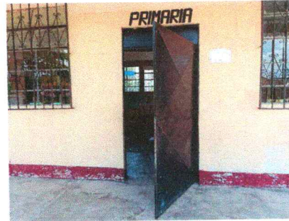
Foto 4: La puerta de aula esta dañada
