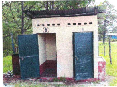
Foto 2: Las puertas de los baños se encuentran deterioradas
