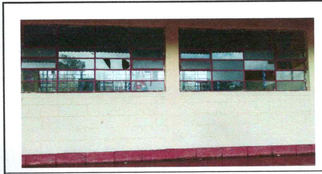
Foto 6: Pintura de todo el centro educativo en mal estado
