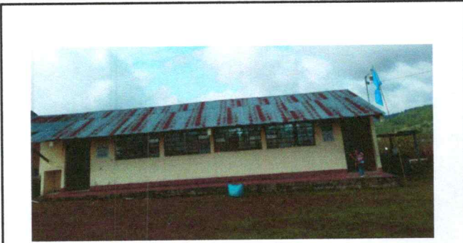
Foto1: Cubierta de lámina en mal estado
