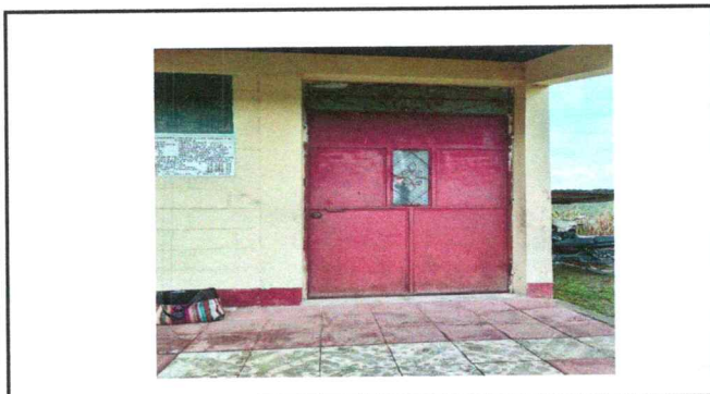
Foto 3: Puertas en mal estado
