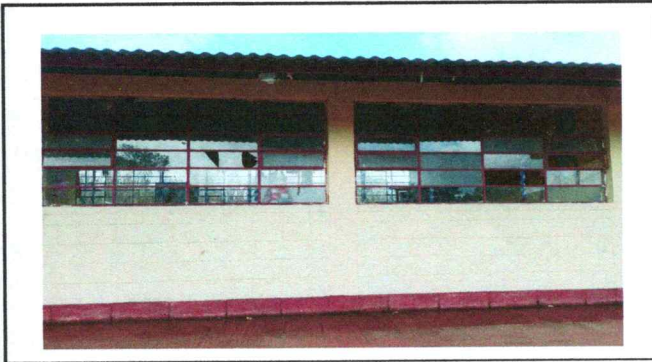
Foto 4: Ventanales expuestos sin balcones, estructuras de balcones en mal estado vidrios quebrados
