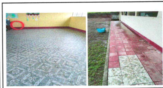
Foto 5: Piso de granito deteriorado en aulas y corredor
