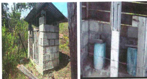
Foto 5: Fosa séptica y sanitarios deteriorados
