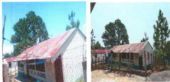
Foto 1: Cubierta de lámina dañada
