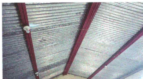
Foto 2: Estructura de soporte en mal estado
