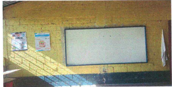
Foto 2: Pintura deteriorada en todo el centro educativo
