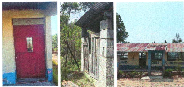
Foto 3: Puertas de metal en mal estado en aulas, puertas de madera en sanitarios dañadas y portón deteriorado
