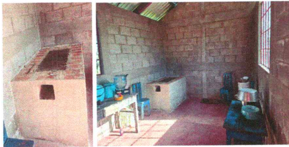
Foto 3: Cocina inadecuada para realizar el proceso de elaboración, manipulación y cocción de alimentos
