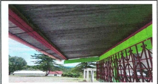
Foto 2: Estructura de soporte de metal en mal estado
