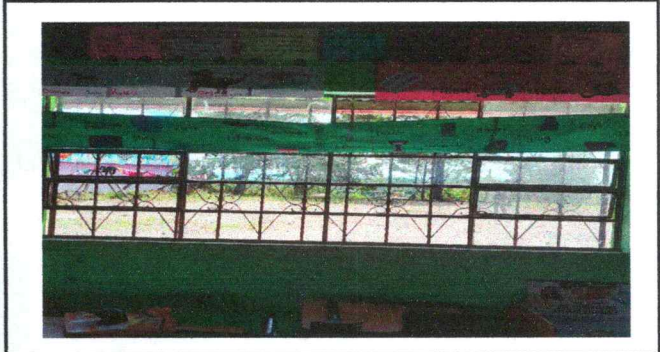
Foto 4: Vidrios detereorados en ventanas de aulas
