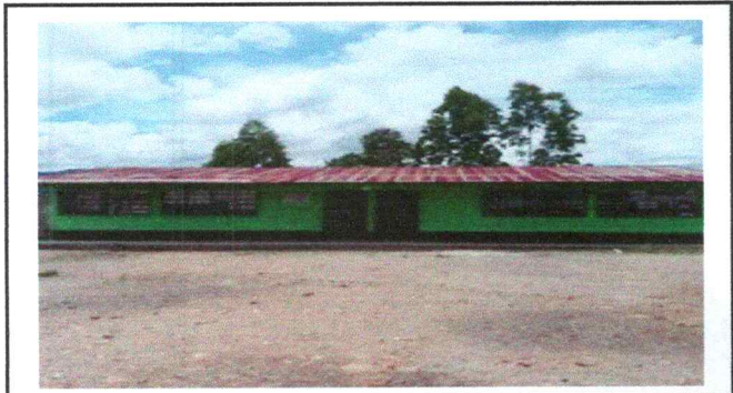
Foto1: Cubierta de lámina en mal detereorada
