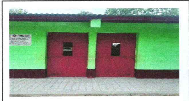
Foto 3: Puertas de metal detereoradas de aulas
