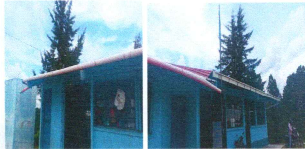
Foto 2: Canal de tubo PVC en mal estado
