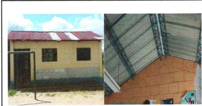
Foto 1: Cubierta de lámina deteoreada
