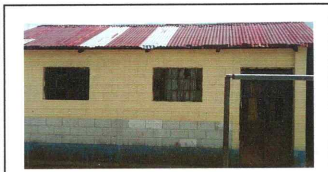
Foto 5: Ventanas expuestas por falta de balcón quebrantan vidrios
