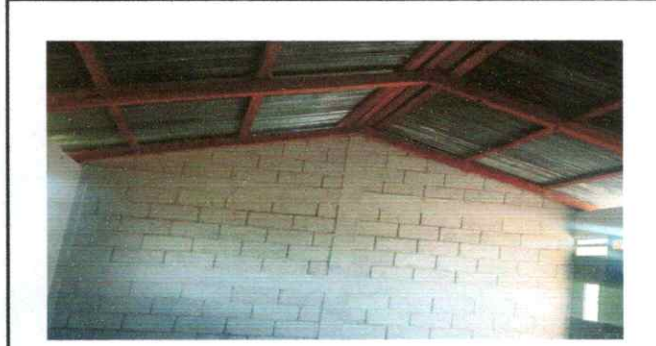
Foto 2: Estructura de soporte y lámina deteoreada
