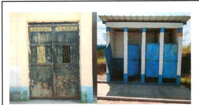
Foto 3: Puertas de aulas deteoreadas
