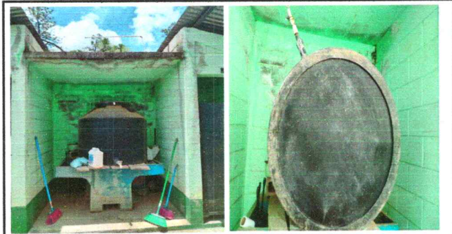
Foto 5: El depósito de agua se encuentra quebrado y en mal estado
