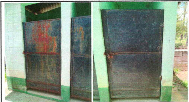
Foto 3: Puertas de servicios sanitarios en mal estado
