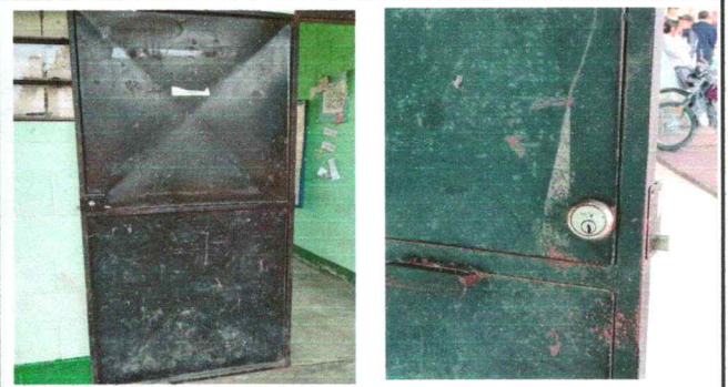
Foto 2: Puertas de metal de aulas en mal estado
