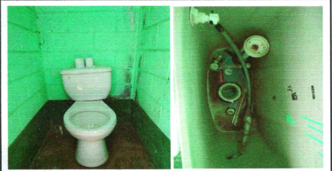
Foto 6: Baños se encuentran en mal estado, falta de accesorios de tanque de agua y reconección de agua potable para tanque
