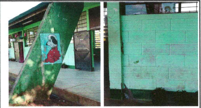
Foto 4: Pintura en muros interiores y exteriores deteriorada
