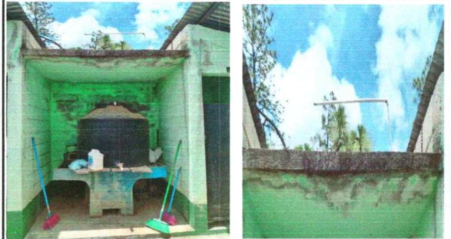
Foto 1: La tubería del agua potable se encuentra inservible
