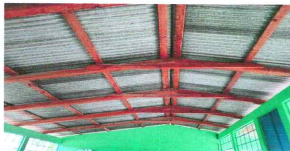
Foto 2: Estructura de soporte y lámina detereorada
