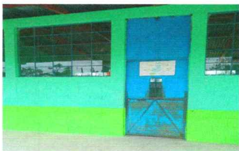
Foto 3: Puertas de aulas detereoradas
