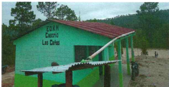
Foto 1: Cubierta de lámina detereorada
