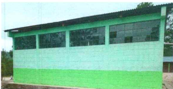
Foto 5: Ventanas expuestas por falta de balcón quebran vidrios
