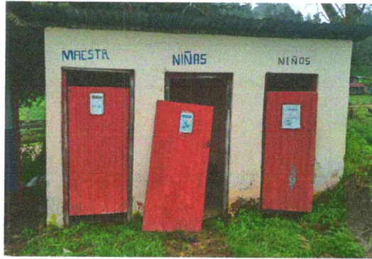
Foto 7: Sustrucción de puertas en servicios sanitarios
