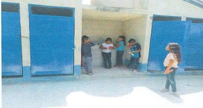
Foto 1: Sustrucción de puertas y servicios sanitarios y sus accesorios
