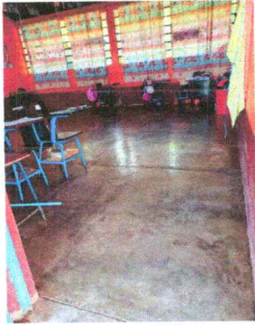
Foto 7: Sustitución de piso de torta de concreto por piso tipo granito de 1"
