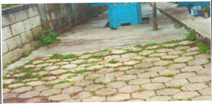
Foto 7: Sustrucción de adoquín por torta de cemento en patio
