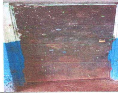
Foto 2: Pintura de puertas, por deterioro. PUERTAS DE METAL
