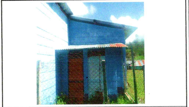
Foto 2: Sustitución de lámina por lámina troquelada calibre 26, Sustitución de elementos de fijacion
