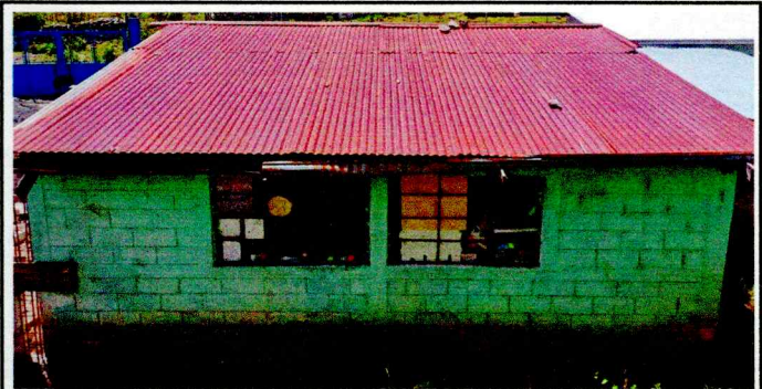
Foto 10: Se debe reparar muros de contención de aula.
