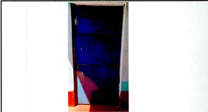
Foto 9: Es necesario sustituir las puertas de metal de cocina.
