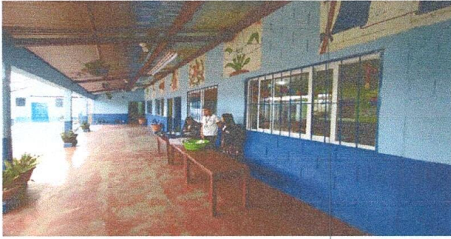
Foto 1, sustitución de ventanas de hierro por PVC , aplicación pintura en interior y exterior
