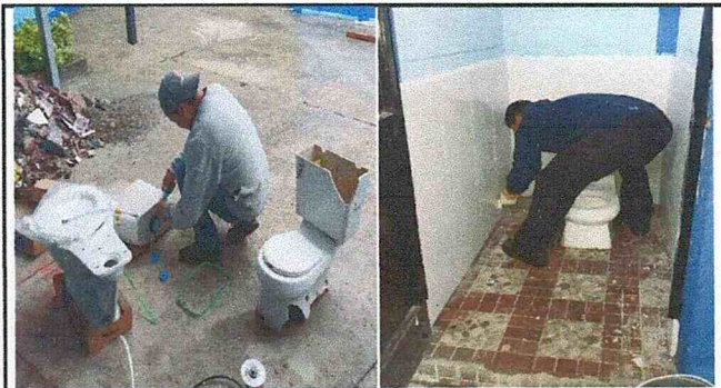
Foto 3: Inodoros en mal estado
