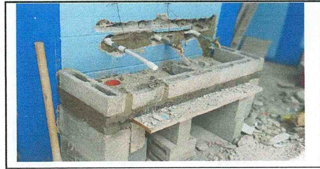
Foto 6: Multilavamanos en malas condiciones.
