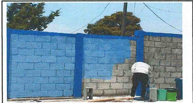
Foto 2: Pintura de paredes en mal estado.
