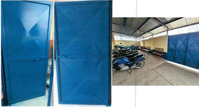
Foto1: Mantenimiento a estructura de puertas de metal (lijado y aplicación de pintura de aceite).
