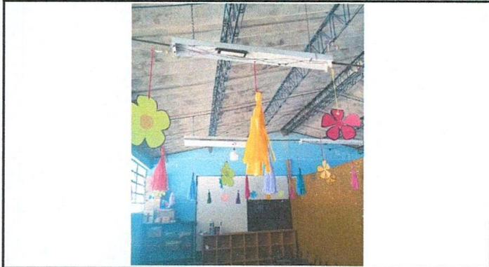
Foto 8: Lámparas en mal funcionamiento
