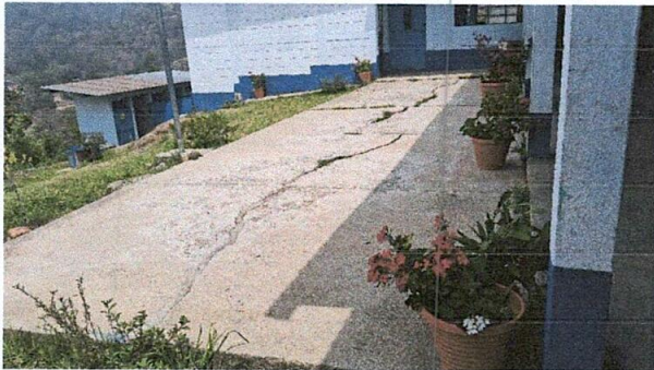
Foto 3: Reparación de planchas de concreto de patio y reforzamiento con muro de contención
