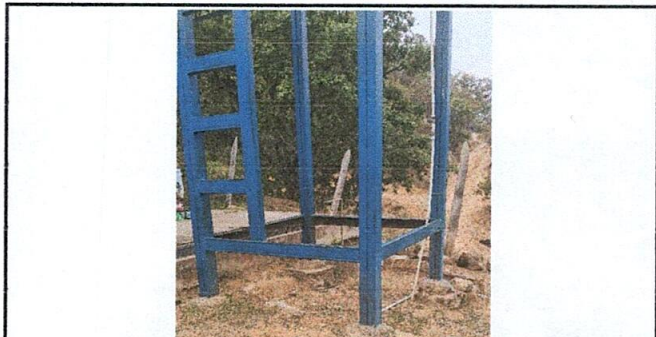
Foto 6: Reforzamiento con concreto de la base de metal para cisterna de agua
