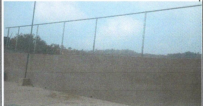
Foto: Reparación de muro perimetral de block con tubo hg malla galvanizada, soleras intermedias y columnas .
