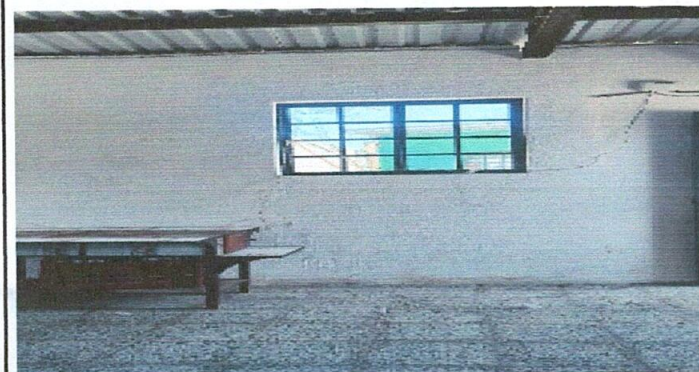
Foto 5: en la cocina se encuentra un muro en malas condiciones por humedad, el cual debe de demoler y sustituir por muro de block, con cemento , columnas y soleras, aquí se puede observar el muro ya
