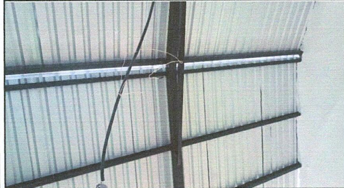
Foto 1: Sustitución de estructura de madera, por metal en modulo 1 conformado por un aula y la cocina
