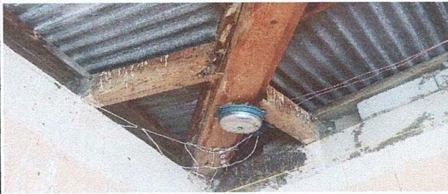
Foto 1: Costaneras en mal estado
