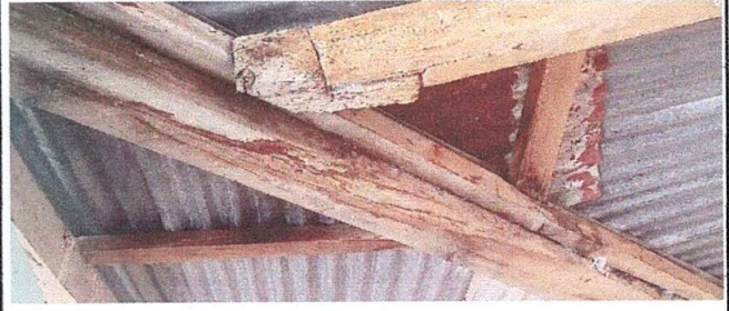
Foto 2: Costaneras en mal estado
