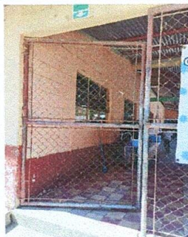
Foto 5: Portón en malas condiciones
