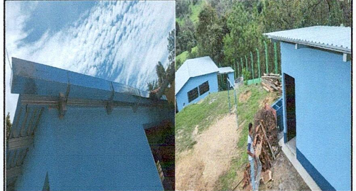
Foto 8: Sustitución de canales y pintura de dos aulas, la dirección, tres sanitarios y la cocina
