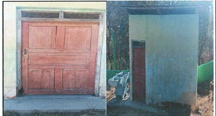
Foto 4: Sustitución de puerta de madera por puerta de metal de la cocina
