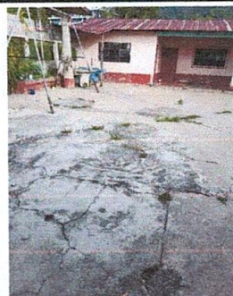
Foto 6: Drenaje con tubería dañada
