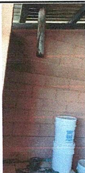
Foto 3: Chimenea en mal estado e incompleta
