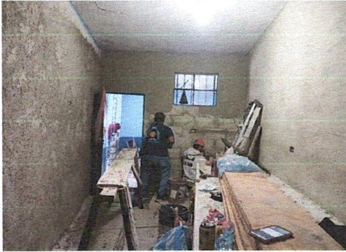
Foto 1: Repellos y cernidos en paredes del ambiente de la cocina
