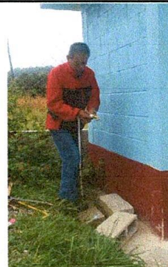
Foto 14 Chorro de baño instalado
