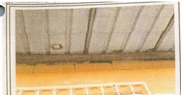
Foto 5: Lámina vieja doblada y con agujeros donde se filtra el agua de lluvia
