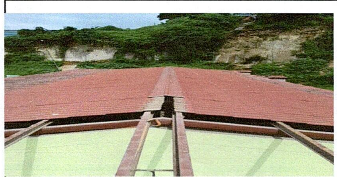
Foto 2: Costaneras oxidadas y lámina de las aulas en mal estado.
