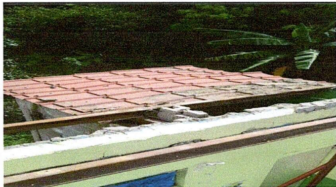
Foto 3: Vista posterior de lámina vieja de las aulas
