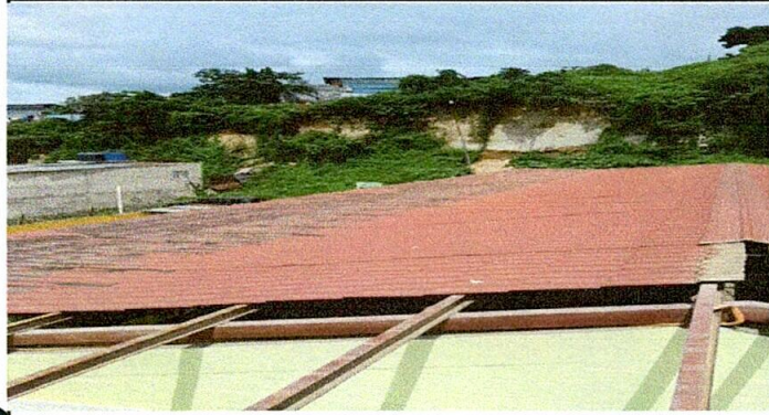
Foto1: costaneras oxidadas y lámina vieja con agujeros
