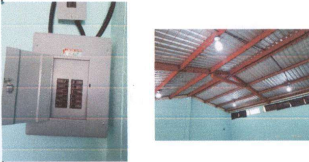
Foto 1: Sistema electrico general
