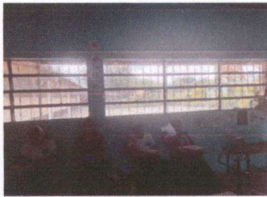
Foto 3: Marciales de ventanas.
