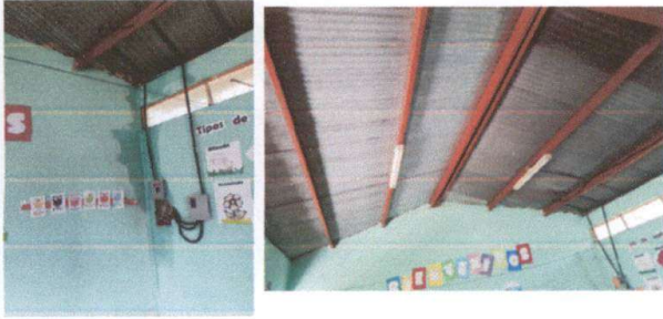
Foto 1: Sistema electrico general
