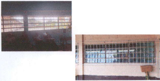
Foto 3: Marciales de ventanas.
