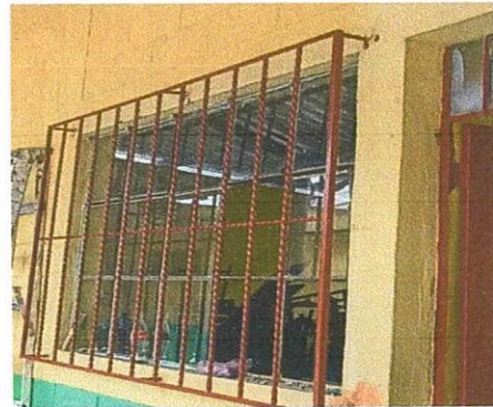
Foto 10: Ventanas fijas a corredizas, Suministro de vidrios nuevos para ventanas porque están quebrados.
