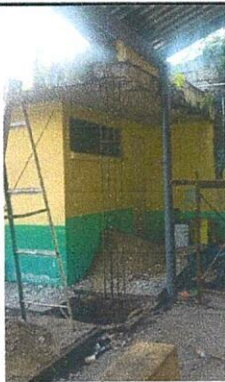
Foto 3: Suministro e instalación de columna de soporte en área de bodega de párvulos
