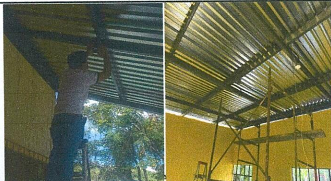
Foto 5: Electricidad en aulas, corredor y bodega
