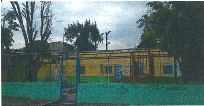
Foto 1: Techo de 2 aulas. Desmontaje de cubierta de lámina existente. Aulas. Suministro e instalación de lámina troquelada Aluzinc calibre 26 (incluye tronillos, sellador)
