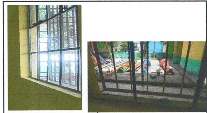
Foto 10: Ventanas fijas que deben convertirse en corredizas, Suministro de vidrios nuevos para ventanas porque están quebrados.
