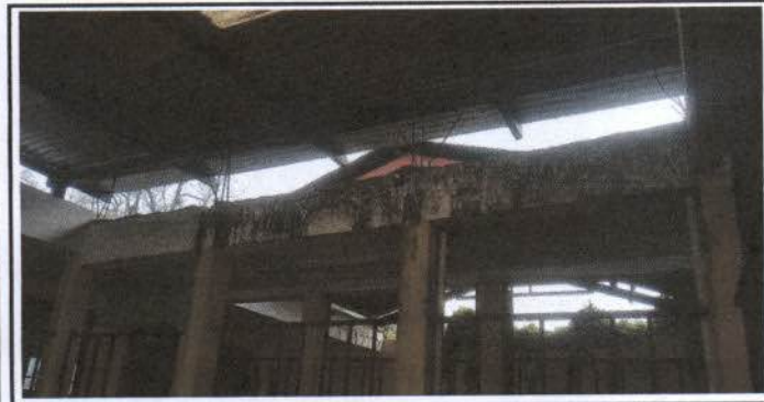
Foto 3: Levantar muro para evitar escurrimiento de agua de la terraza.
