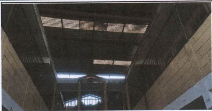
Foto 1: Techo dañado, con agujeros.
